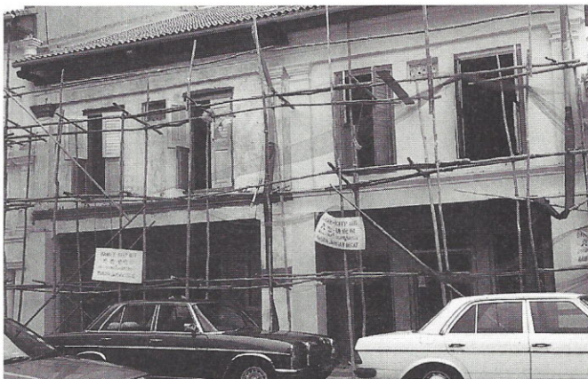
▲ Hvad mod Arbejdstilsynet i Singapore vil sige til dette stillads? Hvis man i det hele taget har et sådant.
